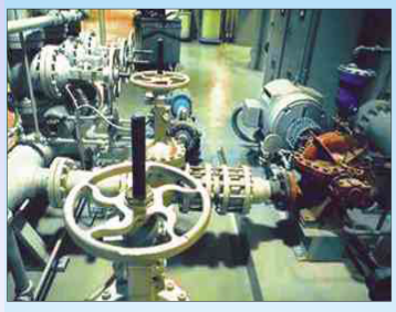
Zonas de fugas o derrames de fluidos
